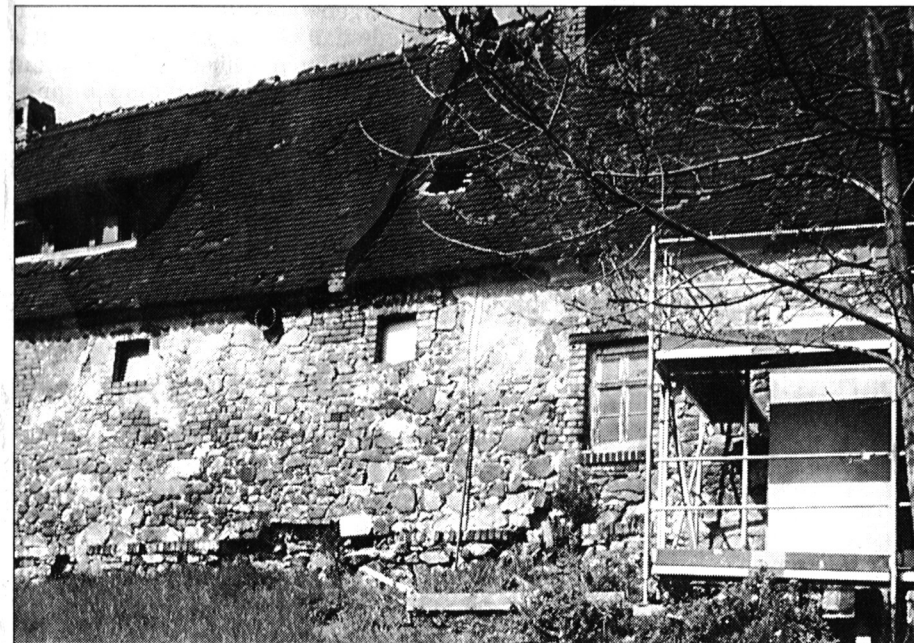
In diesem Jahr wird damit begonnen, vier marode Gebäudeteile des Tauchaer Schlossberges zu sichern. Hier ein Blick auf die Außenmauern.
